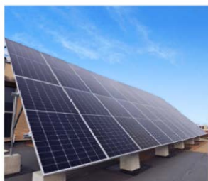
搭建了12kW光伏发电装置
